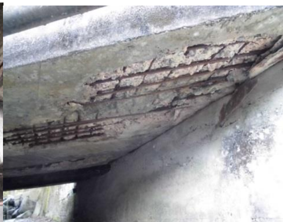
コンクリート桁の剥離・鉄筋露出
