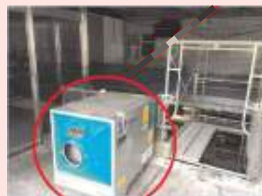
集塵機を設置し室内の換気を実施
