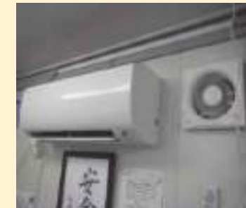
扇風機や換気扇とエアコンを併用
