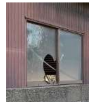
窓が割れた 管理不全空家
