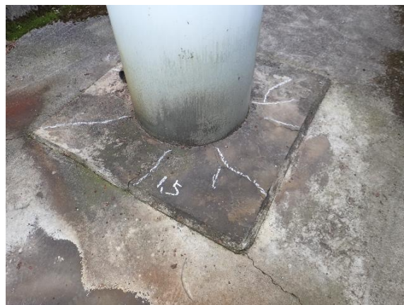
コンクリート基礎のひび割れ
