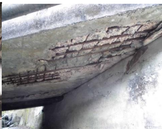
コンクリート桁の剥離・鉄筋露出
