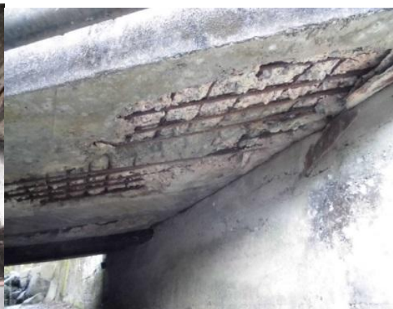
コンクリート桁の剥離・鉄筋露出
