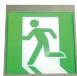
避難口誘導灯
