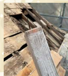
飛檐垂木の彩色 見えていた部分は風化し白色に変色しています
