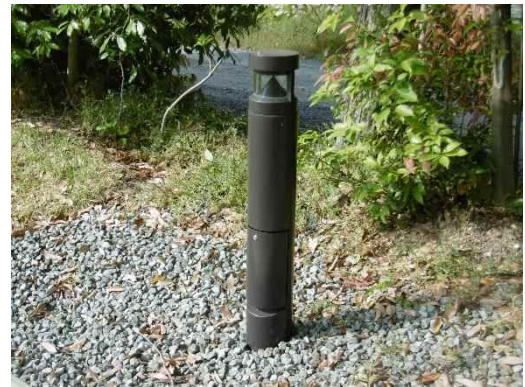
照明設備（足元灯）と一体となったコンセント
