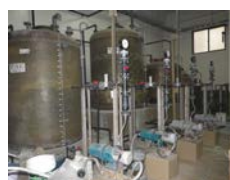
現行薬品注入設備
